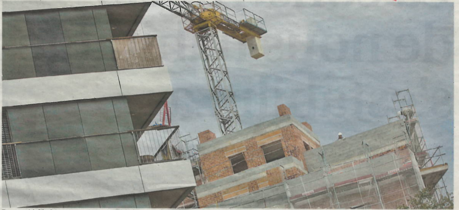
Promoció d'habitatges en construcció al centre de Terrassa, al costat de la zona del Vapor Gran. NEBRIDI ARÓZTEGUI
